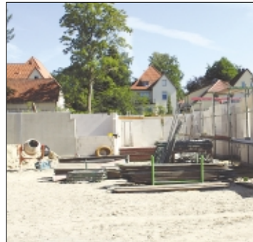
Die Arbeiten auf dem Gelände der Lebenshilfe Soltau in der Winsener Straße gehen gut voran.
