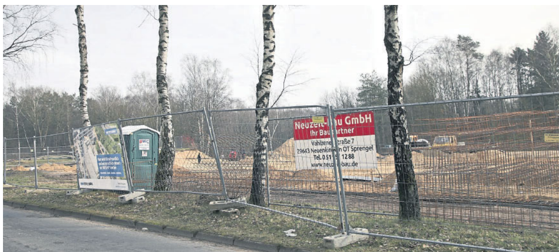
Bevor die Handwerker das Fundament für den ebenerdigen Massivbau legen konnten, musste viel Erde bewegt werden. In dieser Woche wurde die Fläche betoniert. Parallel bereitete die Stadt bereits einen Streifen zum Ausbau eines Geh- und Radwegs vor. Foto: jul
